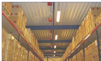
Protección de Almacenes
