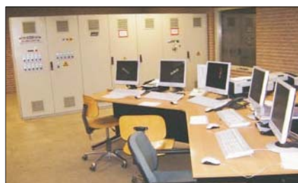
Protección de los centros de control
